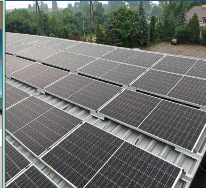
Panele fotowoltaiczne z konstrukcją montażową
